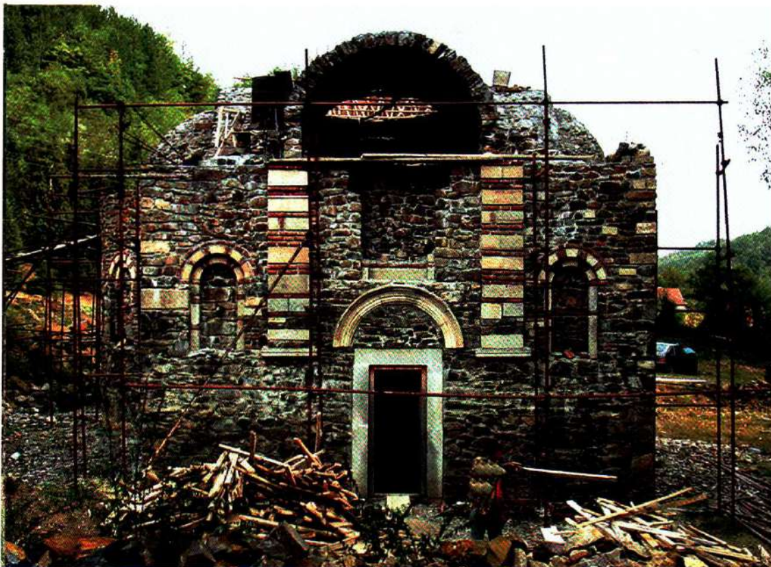
133 Манастир Дренча, обновљена западна фасада до висине кровног венца и изнад западног дела цркве
